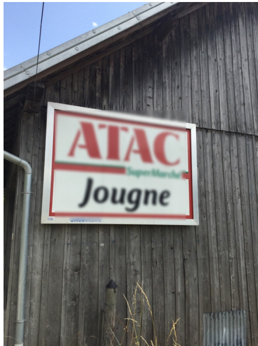
préenseigne sur mur dépassant les limites de l'égout du toit (art. R581-27 C. Env.), La Cluse-et-Mijoux, 2017
